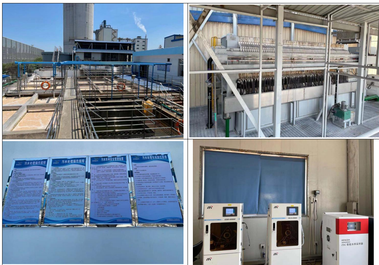
图 3-2 项目污水处理站现状图
