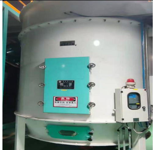
抛光色选工段 4 排气筒废气处理设施
